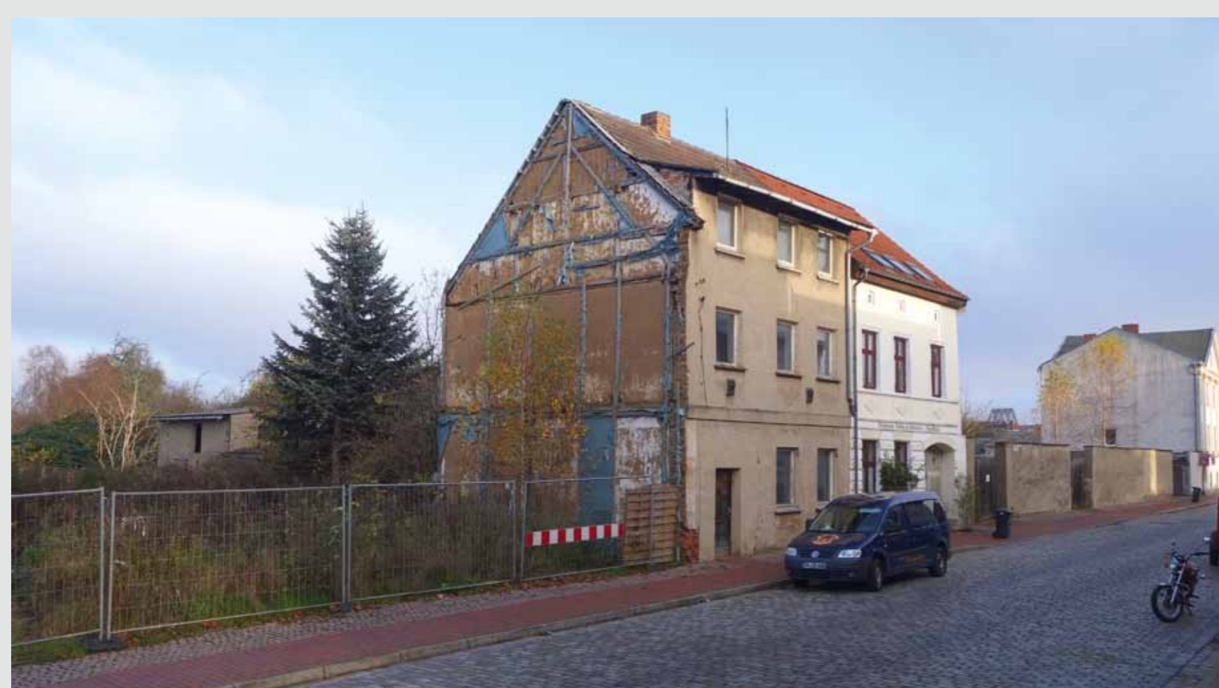
Problematische Baulücken Auf dem Brook
